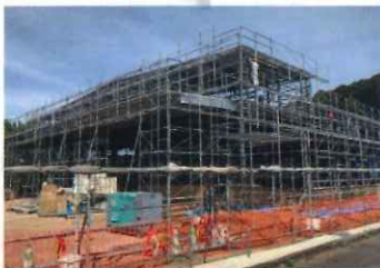
ミナノ精工株式会社 小城事業場新築工事 (電気・機械設備)
